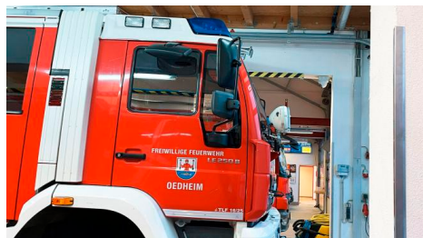
Bild 3: In der Fahrzeughalle sind fünf Thermalkameras installiert, die bei Überschreiten einer festlegbaren Temperatur im Bildbereich eine Meldung an das Alarmsystem absetzen (Bild: Indexa)
